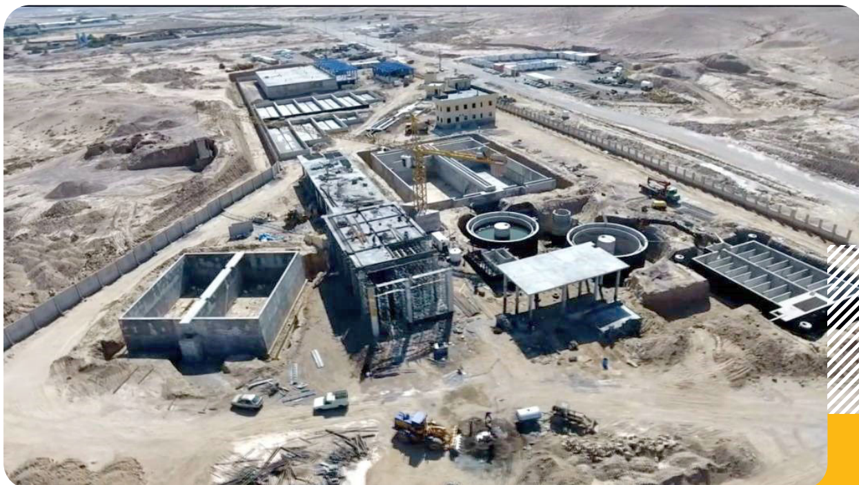
تأسیسات تصفیه خانه فاضلاب شهر خواف
