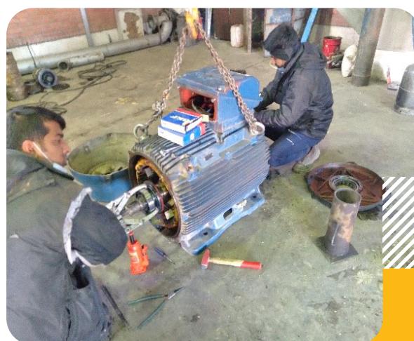
انجام کلیه تعمیرات اساسی الکتروموتورهای ۲۵۰ کیلووات وبلوئرهای هوادهی درداخل تصفیه خانه
