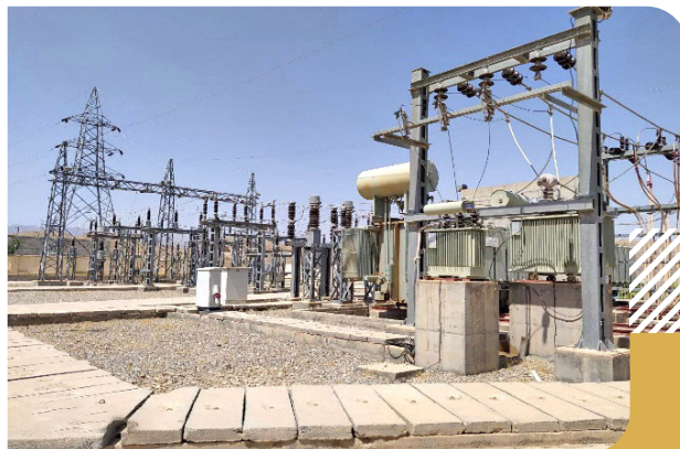
ایستگاه پمپاژ خط انتقال آب زاهدان
