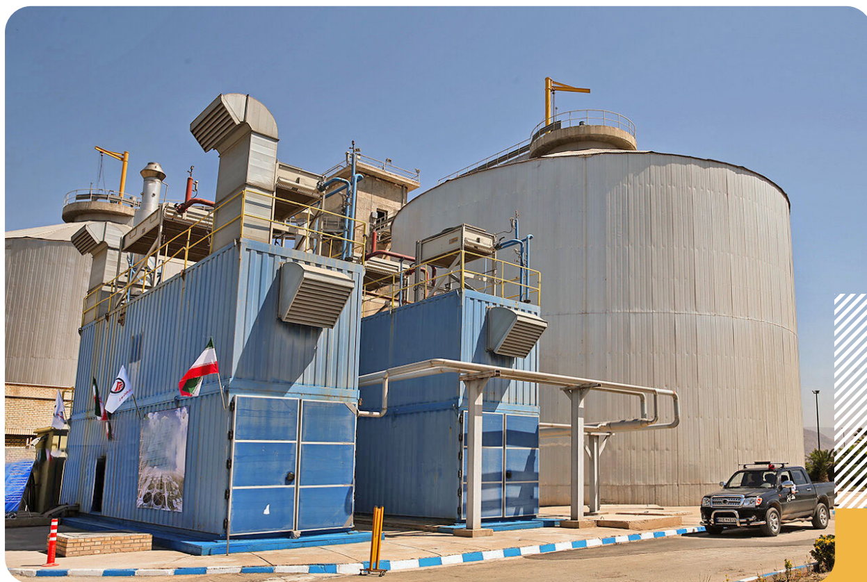
نیروگاه بیوگاز واحدهای ۵ و ۶ تصفیه خانه فاضلاب جنوب تهران با ظرفیت نامی تولید برق ۲٫۴ مگاوات
